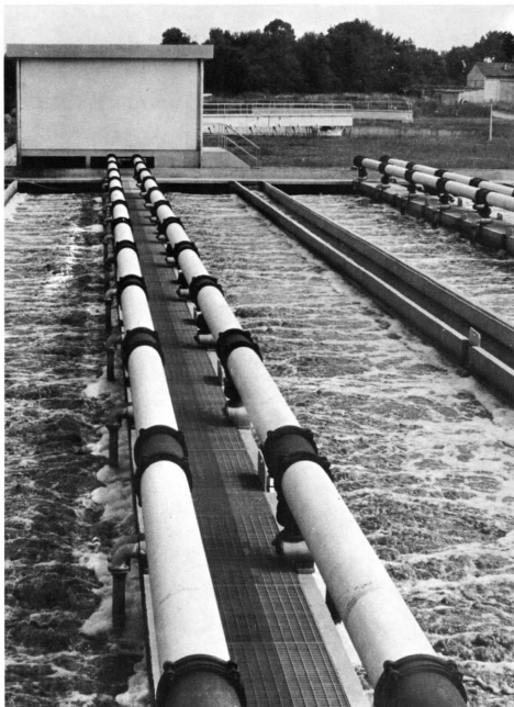
TERMOMECCANICA ITALIANA depurazione delle acque: pista per il trattamento degli scarichi civili
